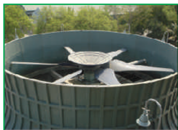
FRP Fan & Fan Stack
